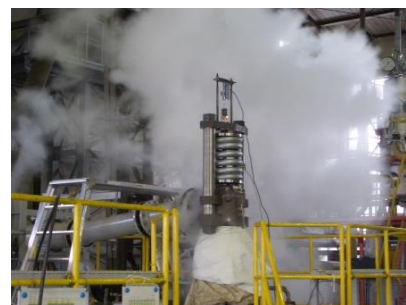
(安全弁の作動漏洩試験)
